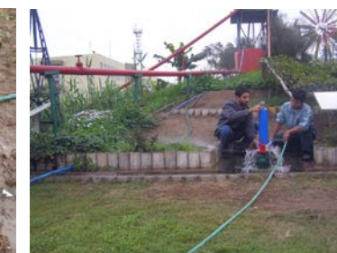
Bomba de ariete funcionando
